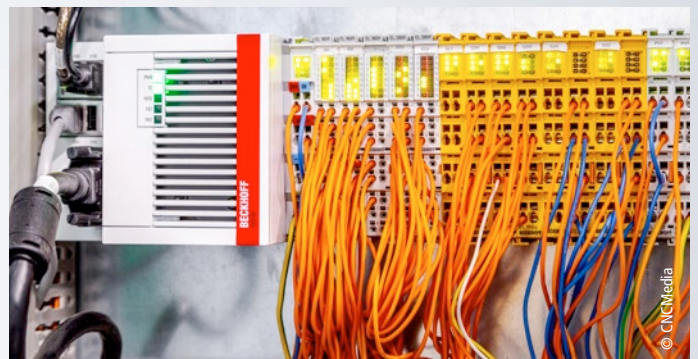
Der Steuerungskern der Faserlaser-Schneidanlage PTL 4001: ein Embedded-PC CX5130 mit TwinCAT 3 und den verschiedensten EtherCAT-Klemmen wie z. B. TwinSAFE-Klemmen EL1904 und Analogklemmen EL3161
