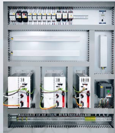
Servoverstärker AX5000 (unten) von Beckhoff im Schaltschrank der Laserschneidmaschine
