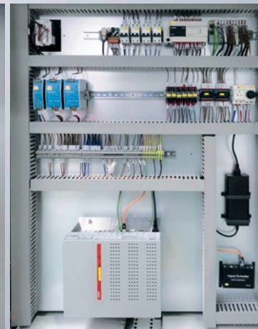
Schaltschrank-Industrie-PC C6640 (unten) für die Maschinensteuerung
