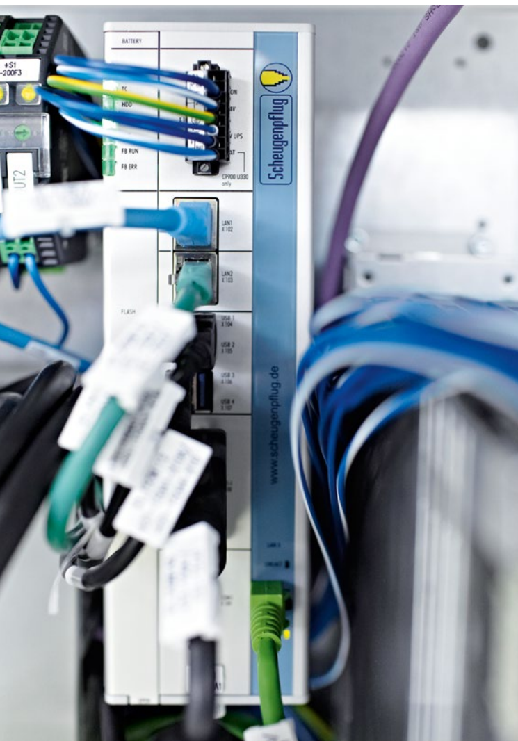
Der Schaltschrank-PC C6920 von Beckhoff – hier als kundenspezifische Ausführung mit Kundenlogo – steuert die komplette Vergussanlage.
