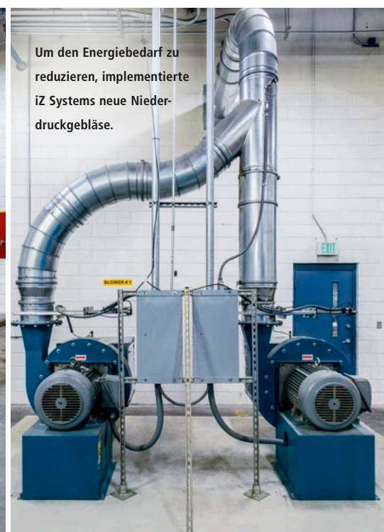
Die Modernisierung des Druckluftsystems im Pactiv-Werk in Macon, Georgia, führt zu jährlichen Energiekosteneinsparungen von rund 250.000 US-Dollar.
