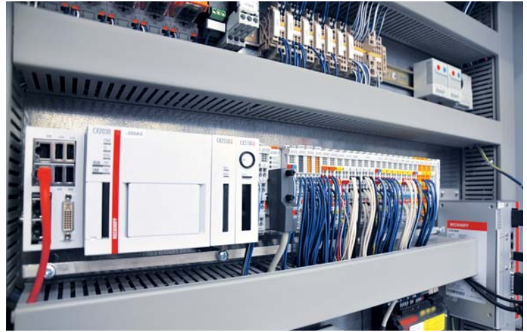
Der Embedded-PC CX2030 (links) im Turmsteuerschrank übernimmt die komplette Anlagensteuerung, wohingegen der Schaltschrank-PC C6930 (rechts) für Visualisierung, Datenhaltung, Monitoring und Fernzugriff zuständig ist.
