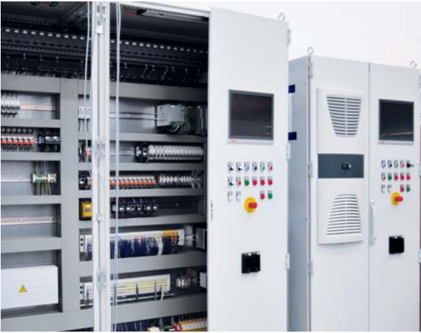
Sowohl im Turmsteuerschrank (rechts) als auch im Gondelsteuerschrank (links) sorgt bei dem WEA-Prototyp ein Multitouch-Control-Panel CP2915 mit 15-Zoll-Display für eine komfortable Bedienung.
