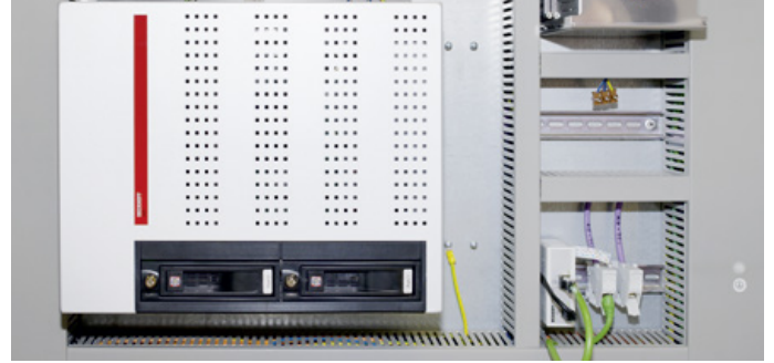
Ein Schaltschrank-PC C6650 mit Multi-Core-Prozessor steuert und überwacht die gesamte Fertigungsanlage zum Herstellen des Werkstoffverbunds Iisocore®.
