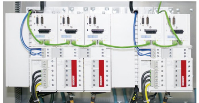
Die Steuerungstechnik der Gesamtanlage verarbeitet über 2500 Datenpunkte und umfasst hardwareseitig u. a. 73 Servoregler AX5000 (Bild), 51 Buskoppler, 778 EtherCAT-Klemmen sowie 22 EtherCAT-I/O-Box-Module.
