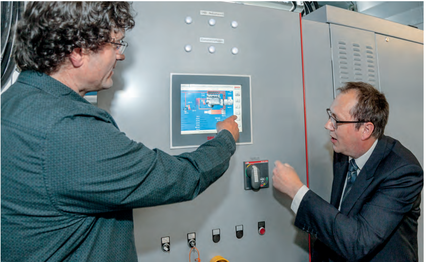
SOKRATHERM-Prokurist Klaus Pollmeier (rechts) und Thomas Kaiser, Vertrieb Beckhoff, beim Prüfstandslauf eines BHKW mit dem Panel-PC CP6201 als zentralem Element.
