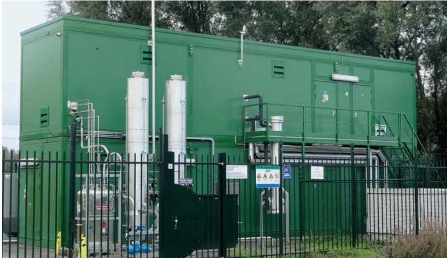
Die von Gastreatment Services entwickelte Grüngasanlage, die am Rande der ehemaligen Mülldeponie Schoteroog installiert wurde, wandelt die Gase, die beim Abbau von organischen Inhaltsstoffen bei der Müllzersetzung entstehen, um in Biogas von Erdgasqualität.
