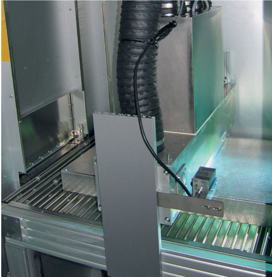
In einer gekapselten Station werden die Kunststoffoberflächen durch von oben strahlendes UV-Licht ausgehärtet.
