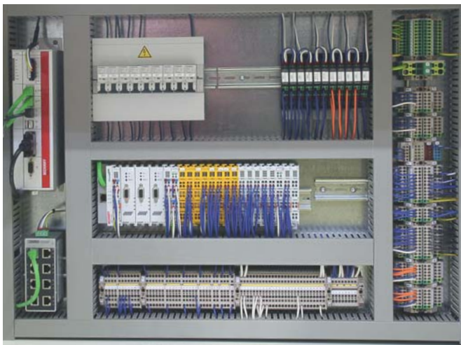
Zentraler Schaltschrank für ein Prozesssegment
