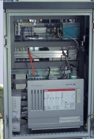
Leitstand der Fertigungslinie, bestehend aus einem Schaltschrank-PC C6140 und einem Beckhoff Control Panel.
