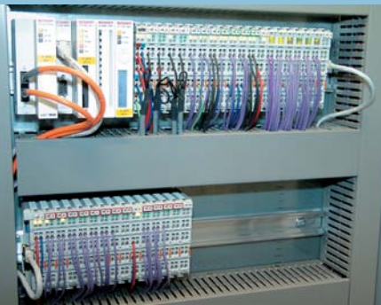
Steuerschrank des Getriebeprüf- stands für das Heckgetriebe mit dem Embedded-PC CX1000
