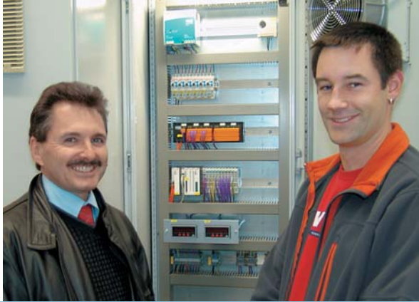
André Duss (rechts), von der BSR Automation AG, und Robert Urech, von der Schweizer Beckhoff Auto- mation AG, vor dem Schaltschrank des MGB-Prüfstands
