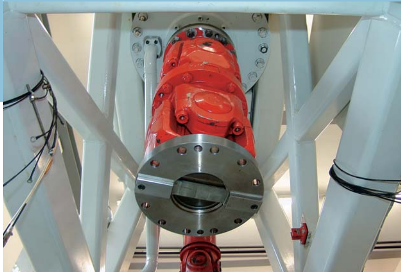
Blick auf die Kopplung von Elektromotorantrieb und Rotorhauptgetriebe im MGB-Prüfstand
