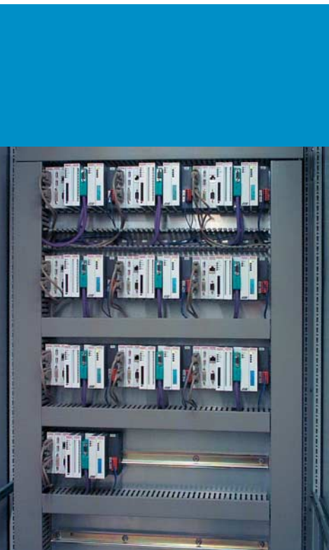
Embedded-PCs CX1000 zur Steuerung der Umlenk- und Führungseinheiten.
