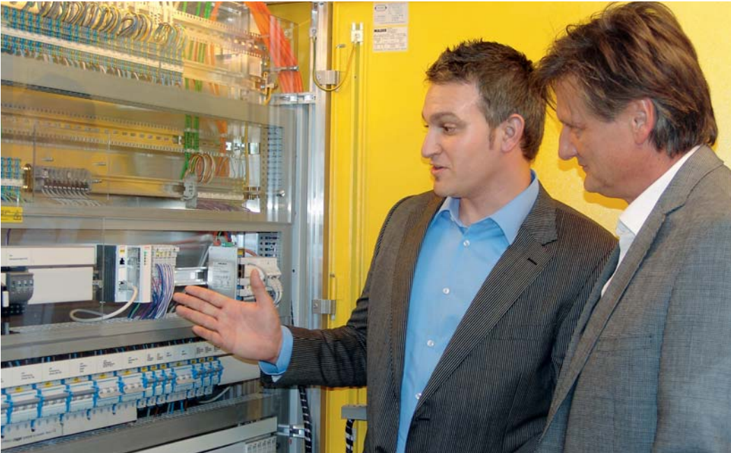
(v.r.n.l.): Markus Gimplinger, Geschäftsleiter von simconex, im Gespräch mit Daniel Rothenberger, Salesmanager Building Automation, von Beckhoff Schweiz, vor dem Schaltschrank im vierten Geschoss des Hotelanbaus.
