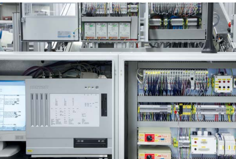
Schaltschrank der Kalibrieranlage
